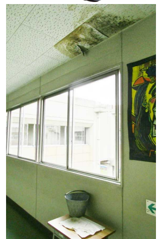
廊下の雨漏り
